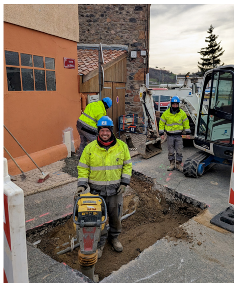
Raccordement par Enedis du nouveau compteur pour les chambres de l'hôtel
