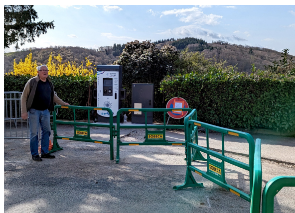
Pose d'une borne électrique sur le parking de la salle des fêtes
